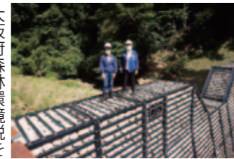
大阪府森林環境税を活用した治山ダム
